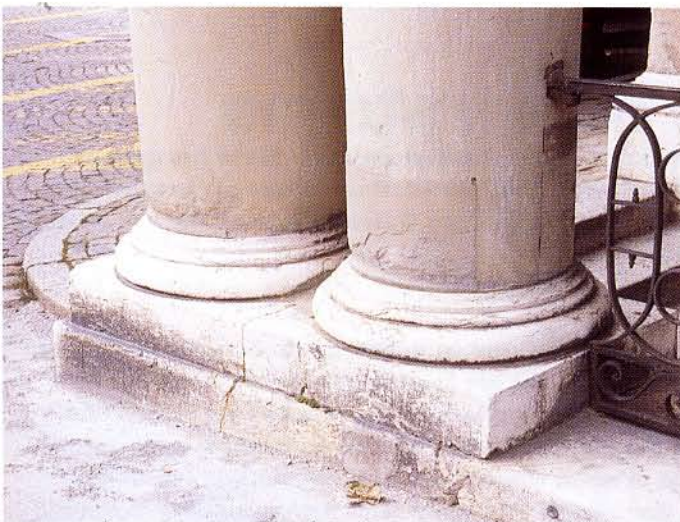
Naturstein in Einheit von Funktion, Form und individueller Eignung = hohe Dauerhaftigkeit = ausgeglichene Ökobilanz. (Pflastersteine Flyschsandstein Voralpen, Randstein Alpengranit, Sockelstein weisser Jurakalk, Säulen Molassesandstein Freiburg). Die Schäden am Sandstein gehen auf zivilisationsbedingte Aktivitäten zurück (Schwefeldioxid, Salze).
