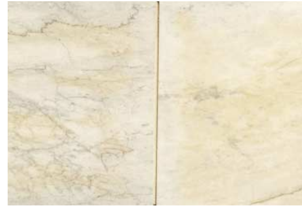
Bild 5: Gelbverfärbung Bianco Carrara auf zementösem Untergrund.
